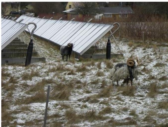
サムソ島の地域熱供給プラント（木質チップ+太陽熱パネル） 太陽熱パネルをおおってしまう草をやぎに食べさせている
