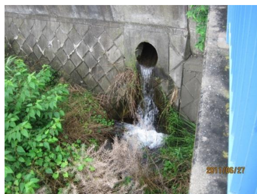
（写真1）御成橋左岸（武蔵野線からの湧水）
